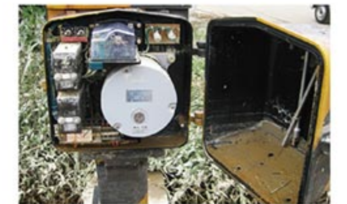
踏切遮断機内泥水流入の様子。
