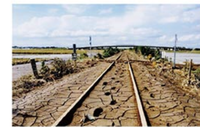
泥に埋まる軌道の様子。(三妻駅～南石下駅間)
