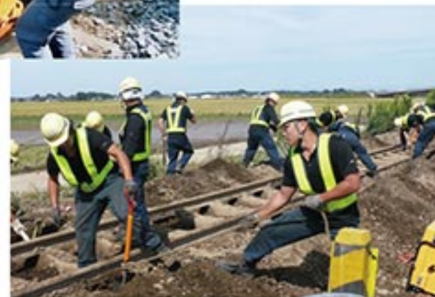
軌道復旧工事の様子。あらゆる箇所で行われた作業が行われました。
