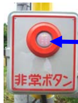
支障報知装置押しボタン
