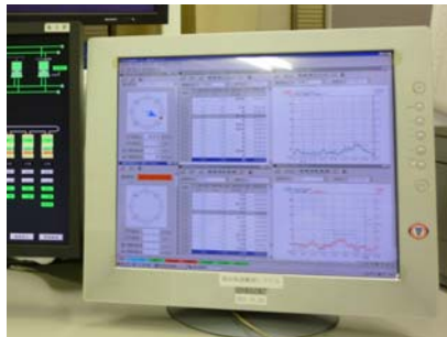
風速・風向監視モニター
