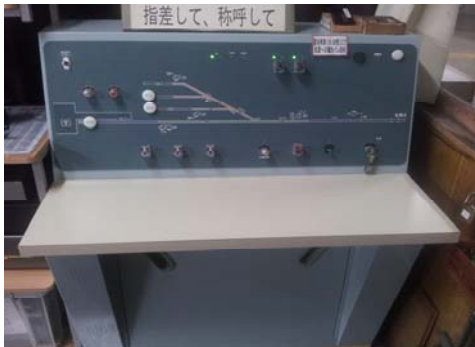
竜ヶ崎駅設置 連動装置
